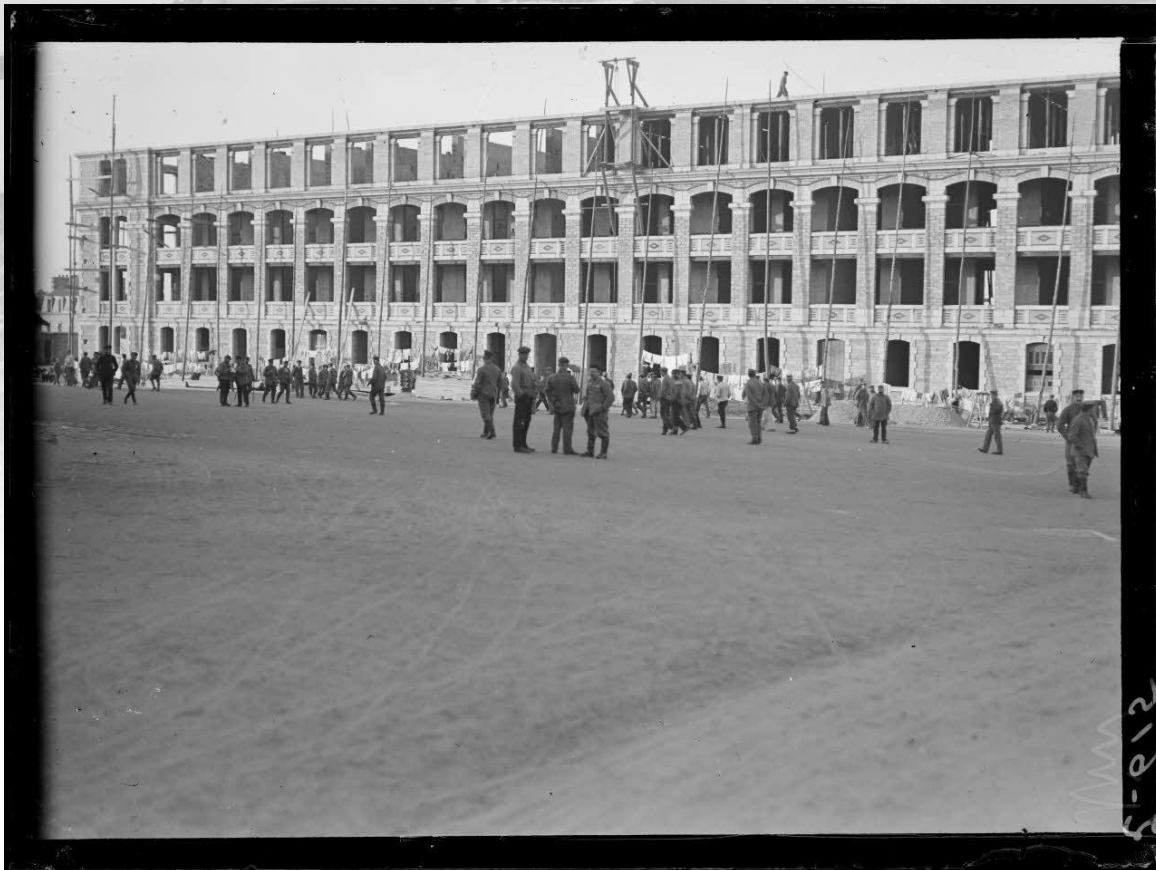
Référence : SPA 18 Z 615 Dinan (Côtes-du-Nord). Dépôt de prisonniers. Le nouveau bâtiment en construction pour les prisonniers. Octobre 1915. Photographe : Schroeder/© ECPAD
